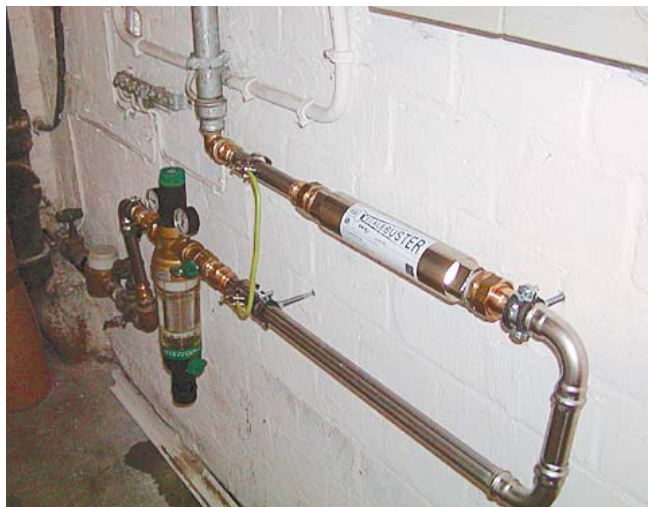
In dem etwa 30 bis 45 cm langen Messingzylinder befindet sich eine hochreine Zinkanode. Bild: Immeo Wohnen
