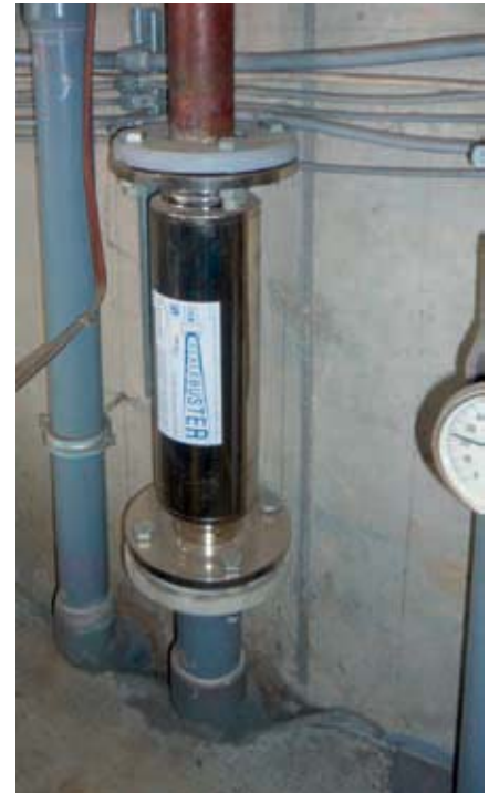
Kleines System – große Wirkung: Das galvanische Wasserbehandlungssystem im zentralen Kühlwassersystem ist vor den Extrudern eingebaut.
